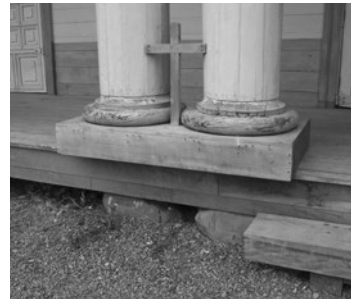
Fig. 163a: Bases de columnas iglesia de Nercón, Comuna de Castro, Chiloé. 1890 (MN). Foto: GCB.
