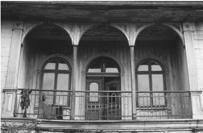
Figs. 88a y b: Pórtico de acceso y balcón rehundido. Calle General Lagos, Valdivia. c.1900. Fotos: GCB.
