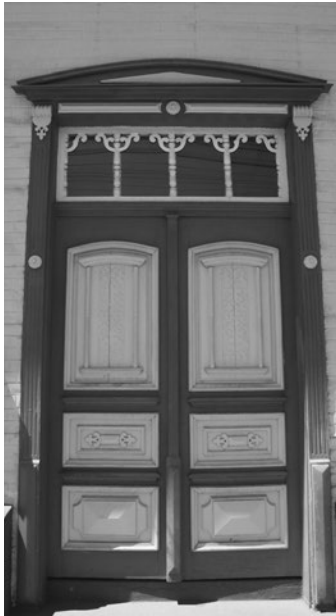
Fig. 221: Puerta atablerada; vivienda en Río Bueno. Foto: GCB.
